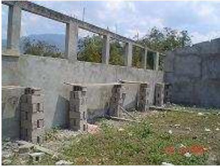
La bibliothèque de Taulabé en cours de construction dans une aile de la Maison de la Culture
